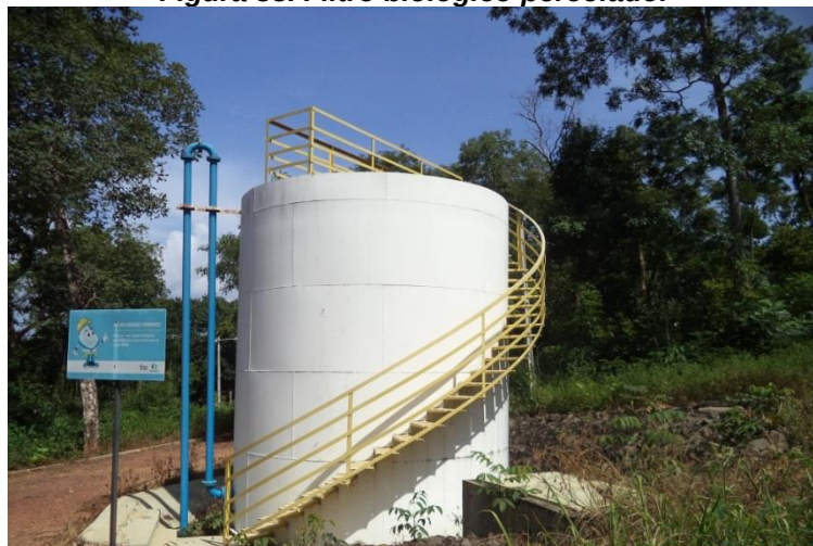
Figura 88. Filtro biológico percolador
