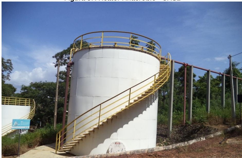
Figura 87. Reator Anaeróbio - UASB
