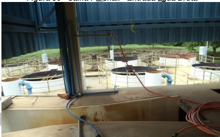
Figura 36 - Calha Parshall - Entrada água Bruta
