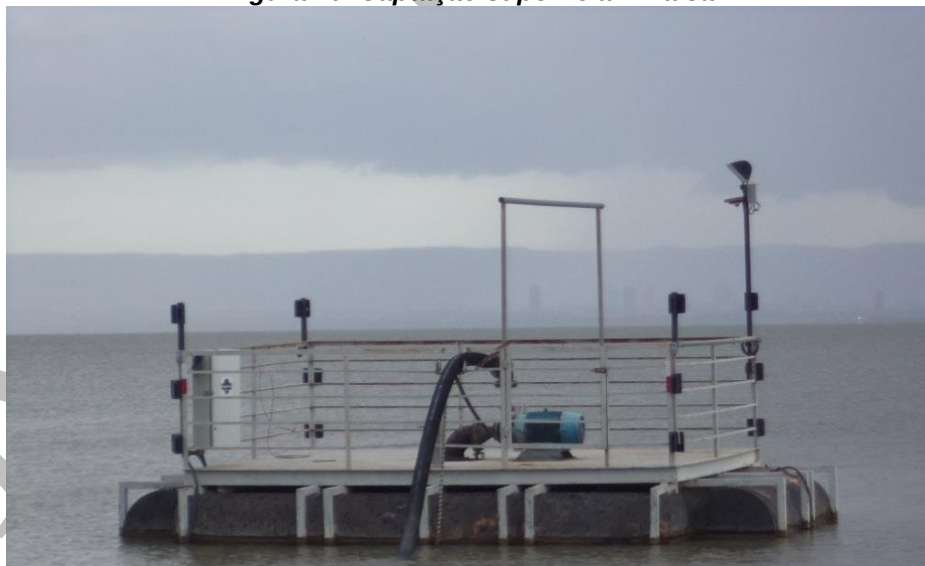
Figura 49. Captação superficial - Balsa
