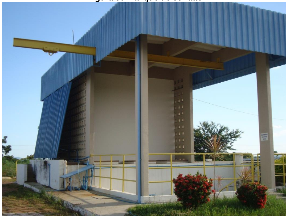
Figura 39. Tanque de contato
