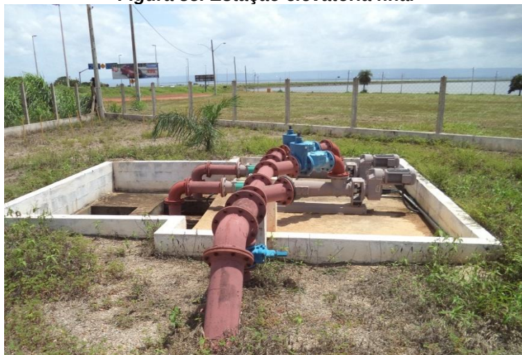
Figura 85. Estação elevatória final
