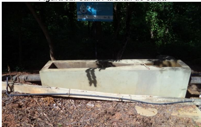
Figura 92. Calha Parshall de saída
