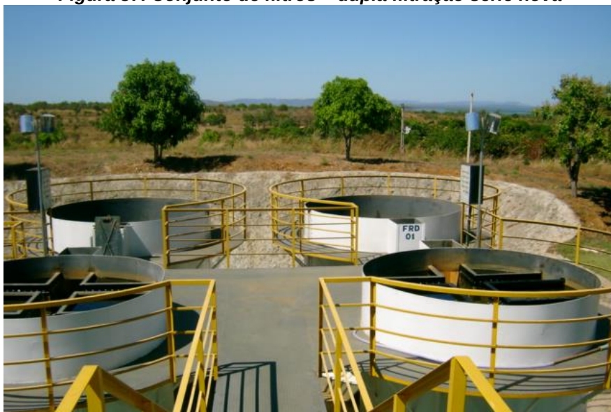
Figura 37. Conjunto de filtros – dupla filtração série nova
