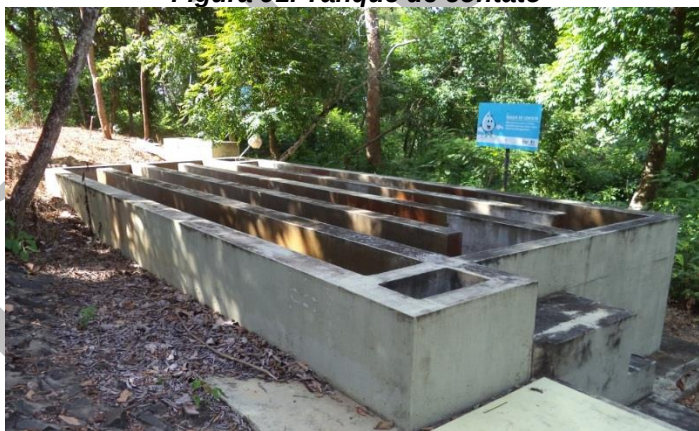
Figura 91. Tanque de contato
